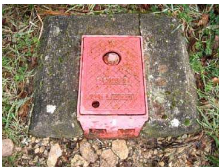
Bouche de lavage fermée
